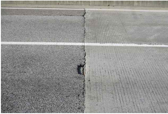
포장부 SPAN.1 파손
