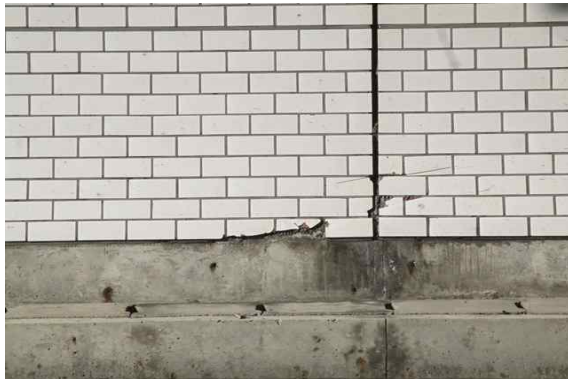
측벽부 SPAN.3 타일 파손
