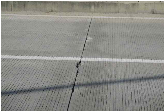
포장부 SPAN.2 파손
