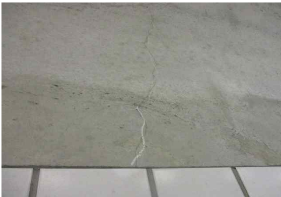
라이닝 SPAN.12 균열(0.3mm미만)
