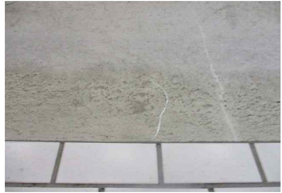
라이닝 SPAN.9 균열(0.3mm미만)
