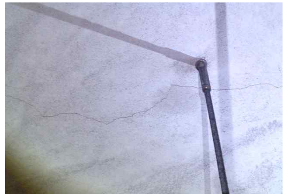
라이닝 SPAN.17 균열(0.3mm이상)
