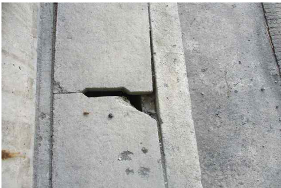
공동구 SPAN.2 덮개 파손
