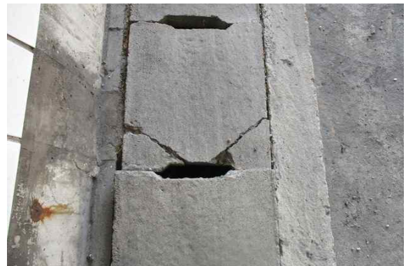
공동구 SPAN.3 덮개 파손
