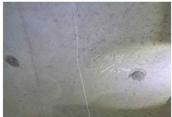
라이닝 SPAN.55 균열(0.3mm미만)
