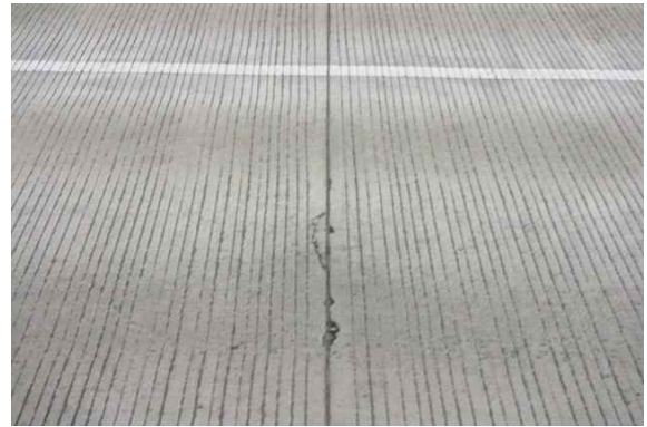
포장부 SPAN.23 파손
