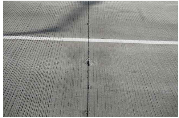
포장부 SPAN.2 파손
