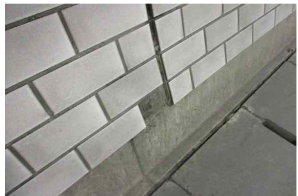
측벽부 SPAN.31 타일 탈락
