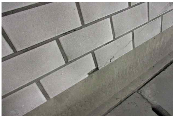
측벽부 SPAN.31 타일 파손
