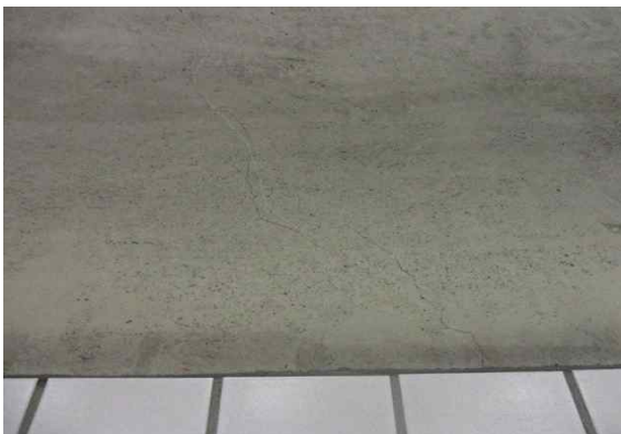
라이닝 SPAN.27 균열(0.3mm미만)
