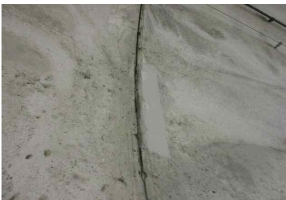
라이닝 SPAN.12 조인트부 파손 보수현황
