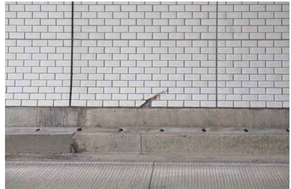
측벽부 SPAN.7 타일 파손
